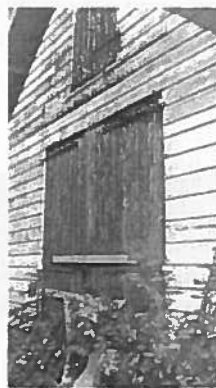
Foto 5; Deur in de achtergevel in zeer slechte staat
