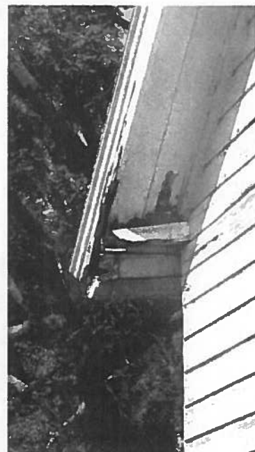
Foto 13; Dakgoot linkerkant achtergevel
