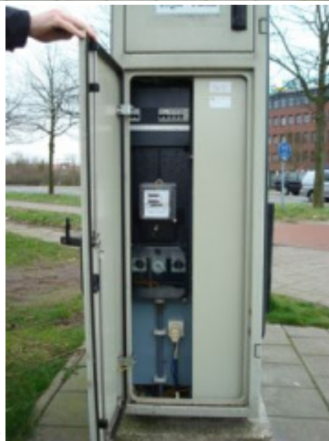
buitenkant - VRI-kast binnenkant
