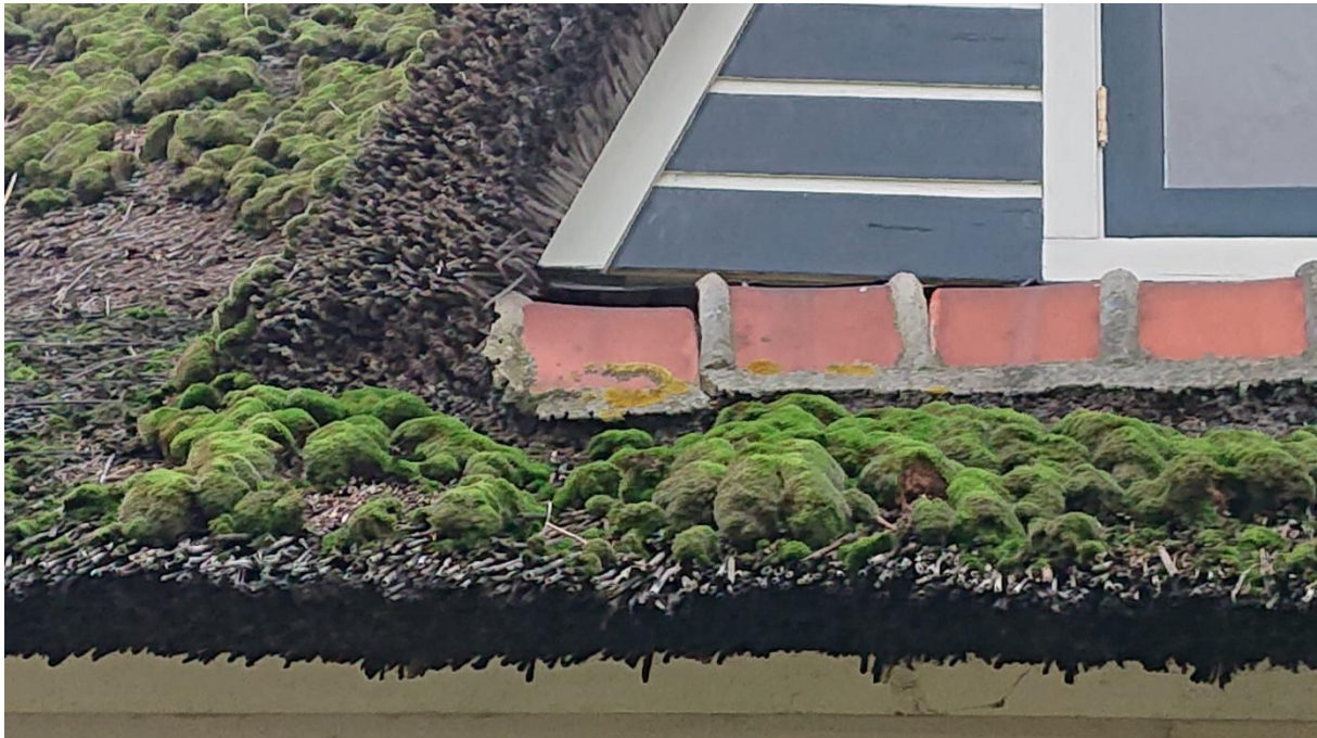
Figuur 6. Gat bij dakpan onder dakraam stolpboerderij oostkant.
