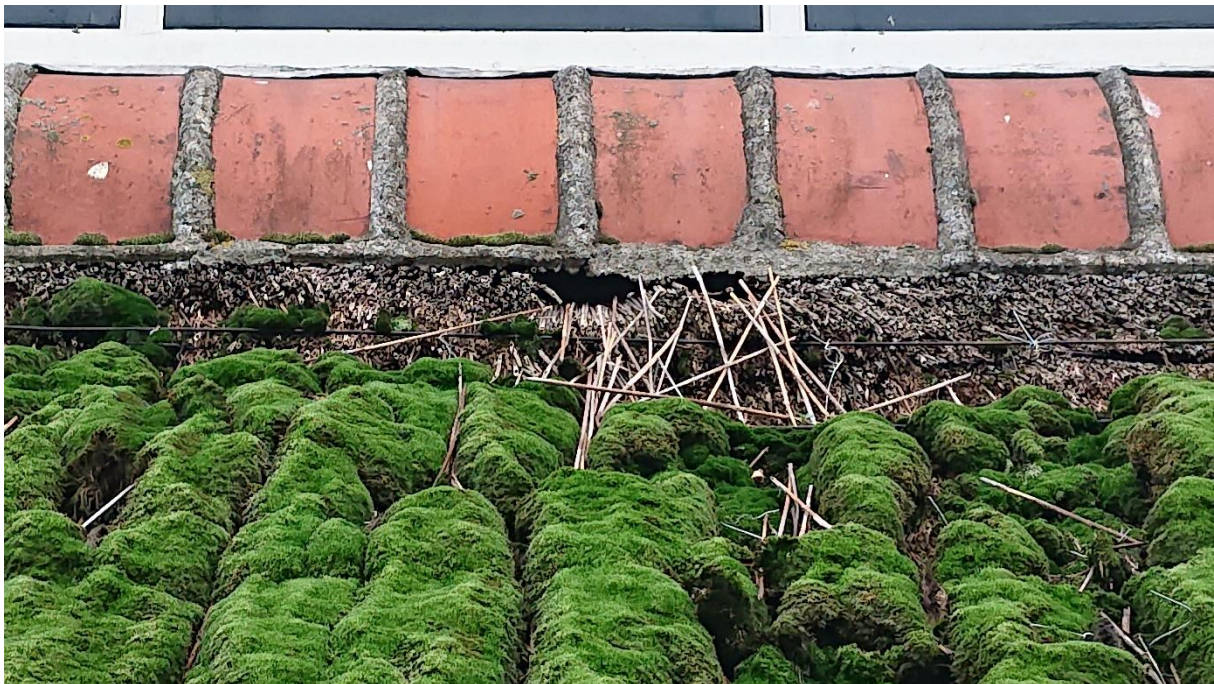
Figuur 7. Gat onder dakpan bij dakraam stolpboerderij westkant.
