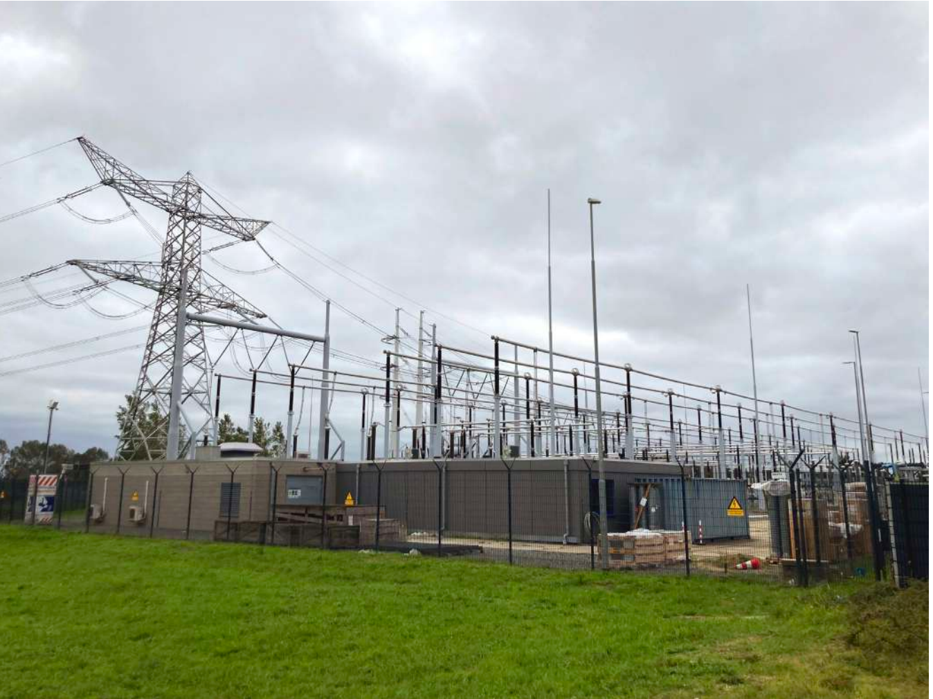
Foto van het bestaande 380 kV-station Beverwijk
