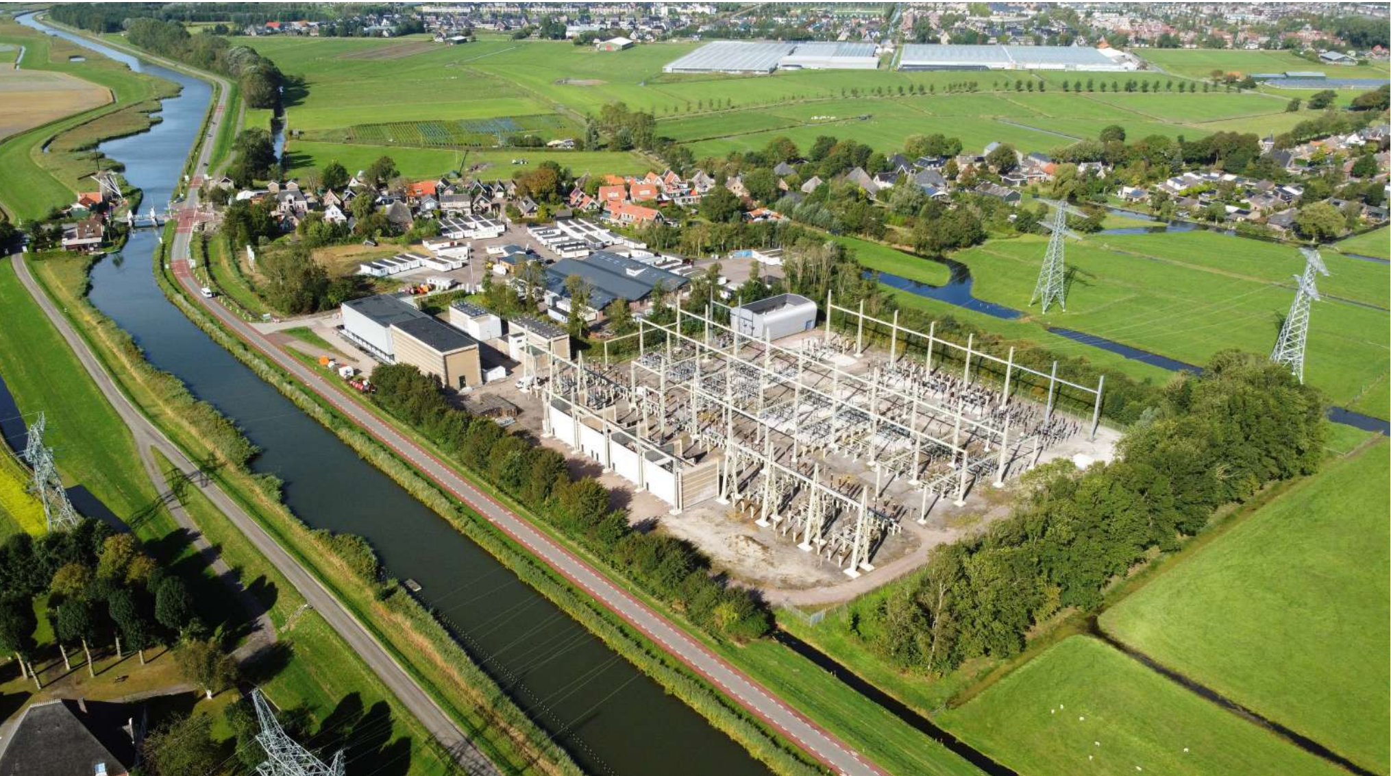
Het 150 kV-station Oterleek sluit aan op het verkavelingspatroon, is gekoppeld aan de grootschalige structuur van de ringvaart en stedelijke rand en is grotendeels landschappelijk ingepast met een groene rand van bosschages
