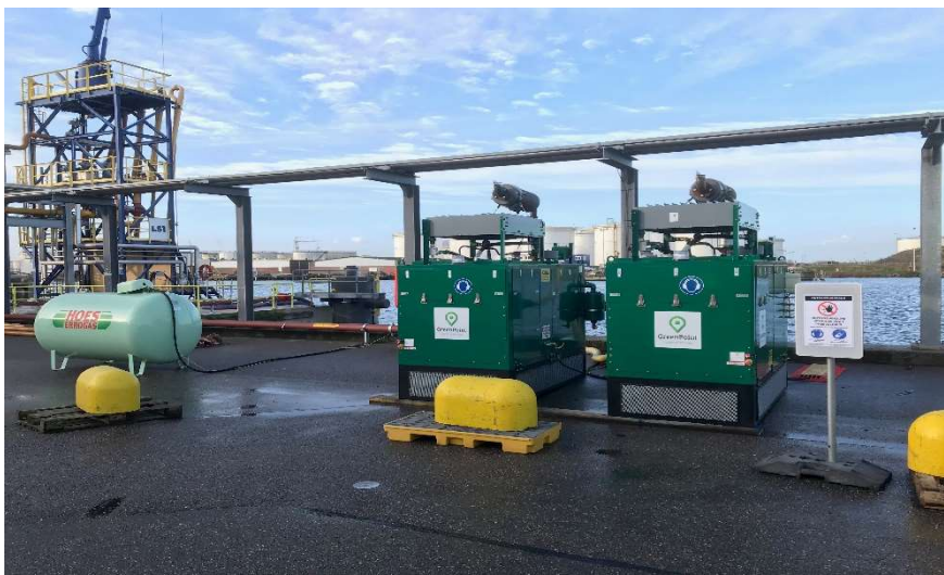
Foto 3: Ontgassingsinstallatie in het Westelijk Havengebied
