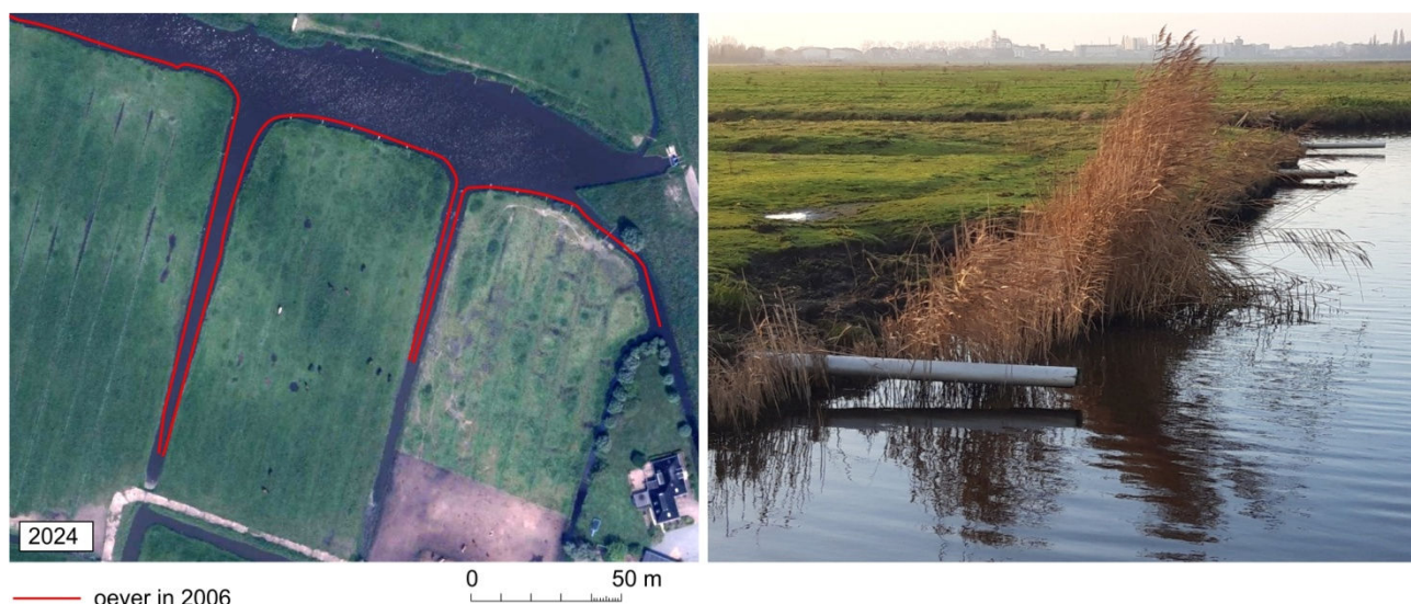
Figuur 52. Langs de meest noordelijk gelegen percelen vindt jaarlijks oeverafslag plaats, van zo'n 8 tot 10 cm per jaar (links). De uiteinden van de uitstekende greppelbuizen langs deze oever (rechts) geven aan waar vroeger de oeverlijn heeft gelegen. Luchtfoto: Topotijdreis, Kadaster. Locatiefoto: Ron van 't Veer, december 2025, perceel 43.
