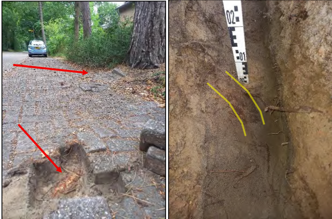
Foto 6 links: Oppervlakkige beworteling van boom 302 met verhardingopdruk.
